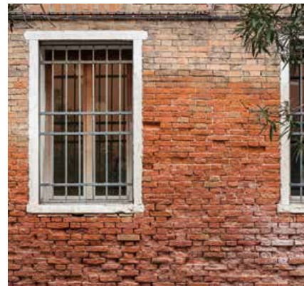
Foto 2: Trotz Putzabschlagens blieb die Mauer teilweise sogar sichtbar feucht.
