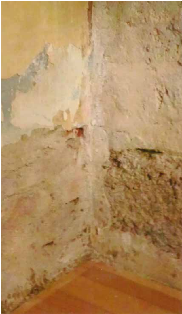
Nach der Entfernung des Altputzes war der Trocknungserfolg, auch für das dahinterliegende Mauerwerk, deutlich zu erkennen.
